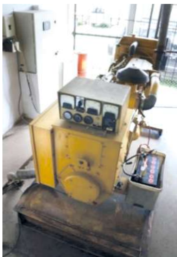
Figura 54. Generador eléctrico de emergencia INIAP-DENAREF-EESC, 2025.
