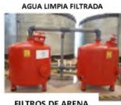
FILTROS DE ARENA
