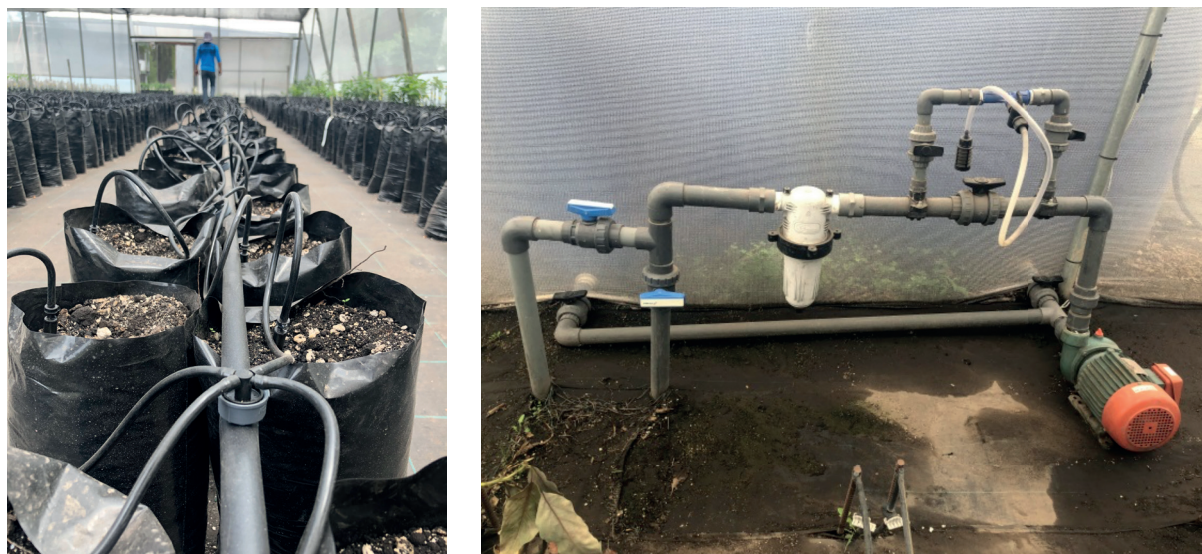
Figura 8. Equipo de sistema de riego
