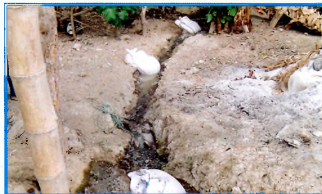
Foto de canal de tierra con sacos de arena., para descarga de aguas residuales
